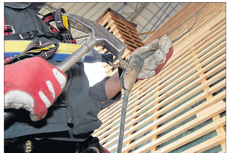
Die Schutzausrüstung der Handwerker muss regelmäßig kontrolliert werden.
